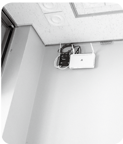
庁舎内の Wi-Fi 機器
