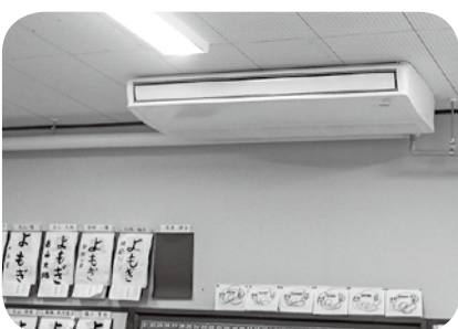
小学校の教室に設置されたエアコン
