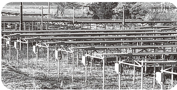
太陽光発電設備
