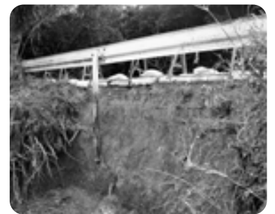
道路の路肩崩壊現場
