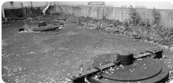
中学校浄化槽
